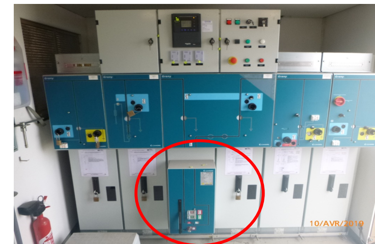
Exemple d’ensemble de cellule Haute Tension dans le poste de livraison (PDL) d’un parc éolien. Le disjoncteur HT est entouré en rouge.
